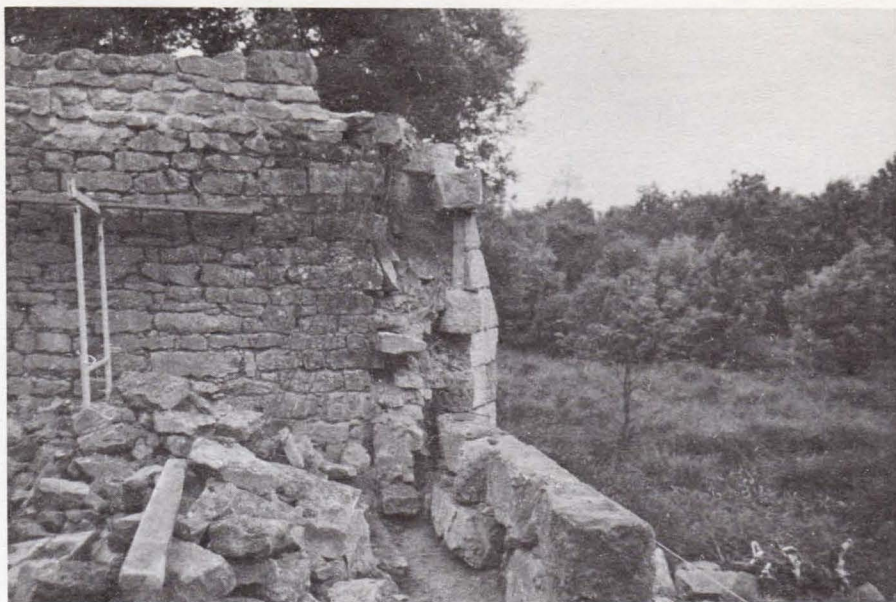
La chapelle du Loc'h en Peumerit Quintin : mur est du transept nord, présentant des risques d'effondrement, déposé en juin 1987.
