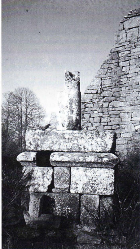
A Querrien, au lieudit La Croix Rouge, un calvaire a besoin d'une rénovation.
