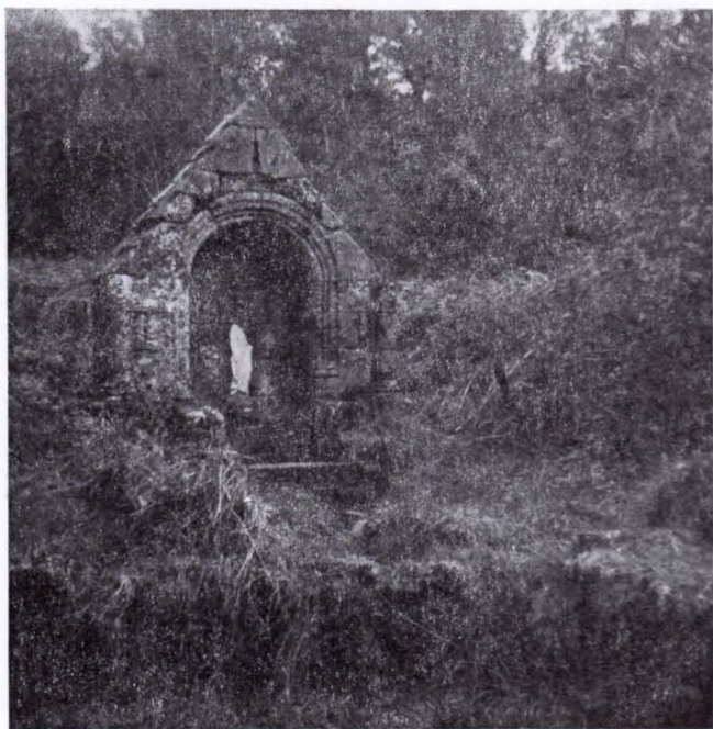
Fontaine SAINTE-BRIGIDE à l'abandon, avant les travaux.
