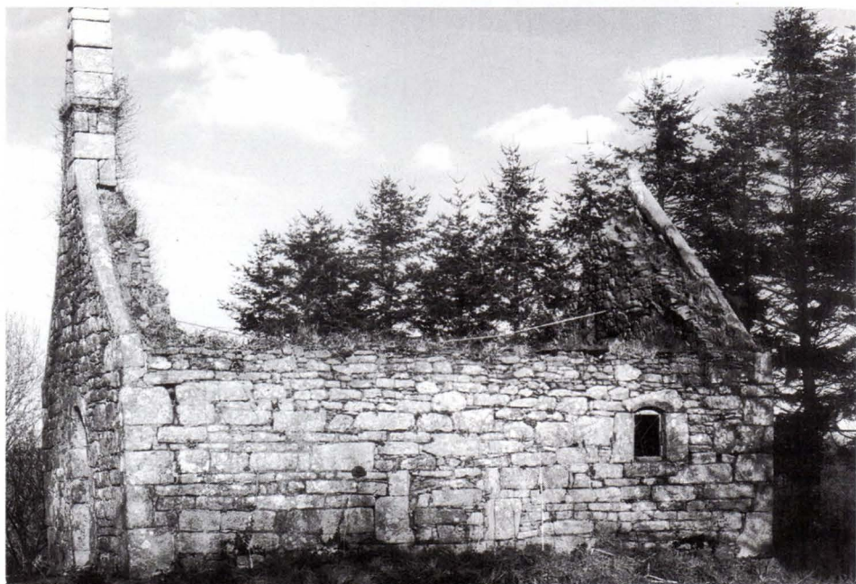
La chapelle Saint-Yves-du-Bergot à Lannilis, après la chute de son clocher, puis avec son pignon remonté.
