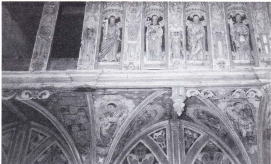
l'affreux vide laissé par la disparition des panneaux du jubé de la chapelle Saint-Nicolas (Photo A. de Couesnongle).
